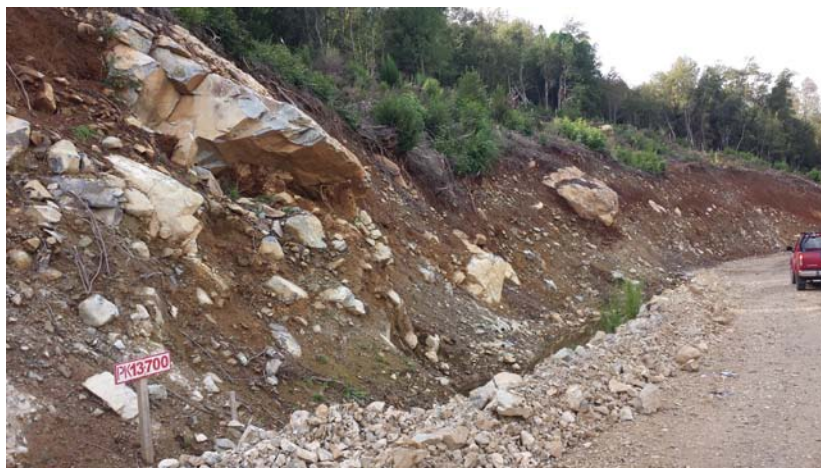
Foto 5: Zona con presencia de Bolones de roca en PK-13.700
