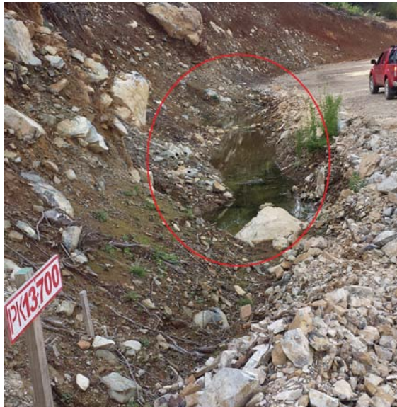
Foto 6: PK-13.700 con presencia de agua que escurre de entre las rocas.
