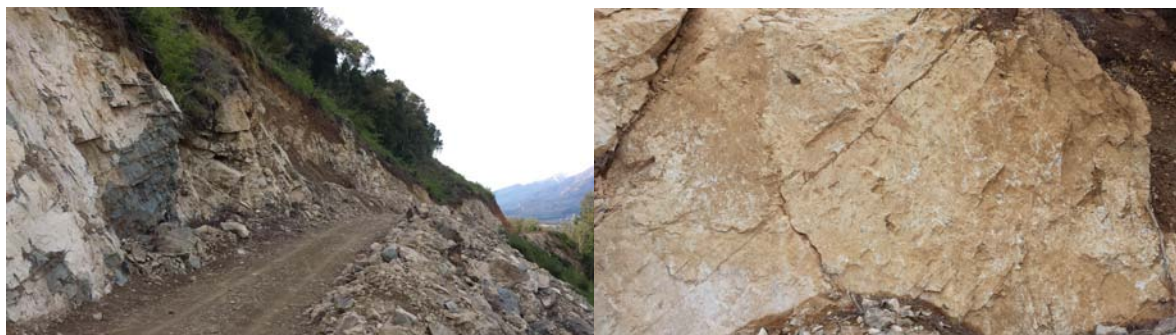
Foto 4: Zona Rocosa PK-14.600 al PK-14.200
